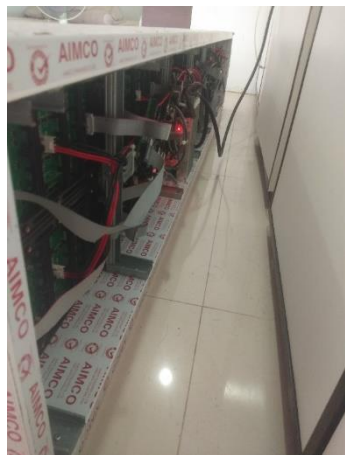
ภาพที่ 16 ด้านหลังของแผงไฟแอลอีดี
