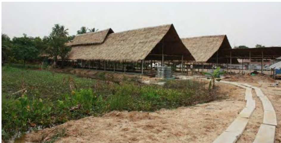
ภาพที่ 23 ตลาดน้ำคลองลัดมะยมในที่ดินของคุณฉลา ซึ่งกำลังอยู่ในระหว่างการก่อสร้าง พ.ศ. 2553
